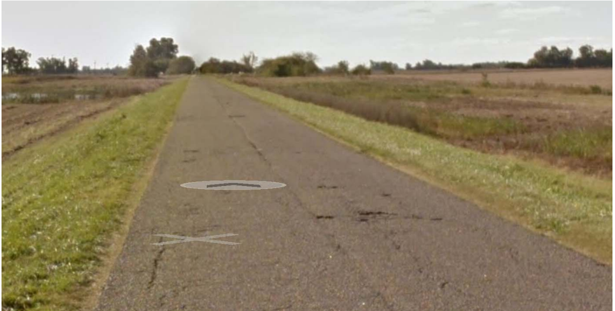
Imagen 3. Deterioro en R. P. N° 68. Partido de Lincoln
