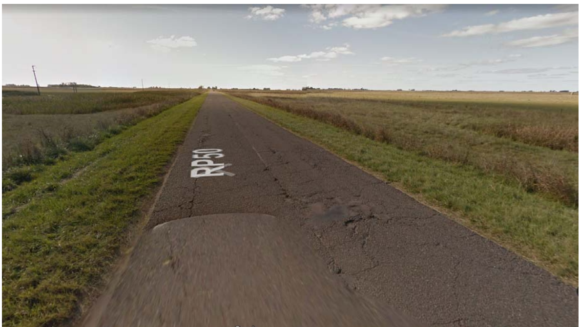
Imagen 4. Deterioro en R. P. N° 50. Partido de Lincoln
